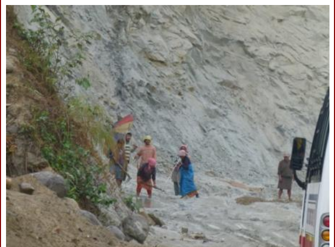
Straßenarbeiterinnen versuchen, das Wasser abzuleiten
